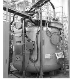
Almacenamiento de energía magnética con superconductores (SMES) 13 .
